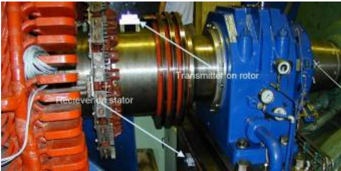
Slika 3: Beskontaktni rotor monitor ugrađen
